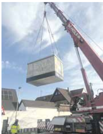
Neue Trafostation in Ottersdorf. Foto: Stadtwerke Rastatt
