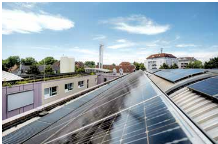
PV-Anlage in der Markgrafenstraße
