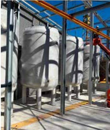
Die Edelstahlfilterstation entfernt sicher und zuverlässig PFAS aus dem Wasser.
