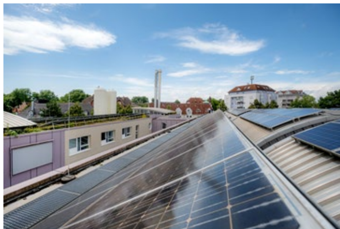
Eine der Stadstrom-Solaranlagen befindet sich auf dem Dach des Unternehmenssitzes der Stadtwerke Rastatt in der Markgrafenstraße.
