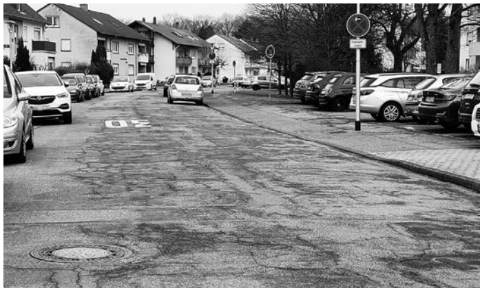
In der übel zugerichteten Danziger Straße rücken voraussichtlich erst im Jahr 2026 die Baumaschinen an. Foto: Gerhard Schauppel
